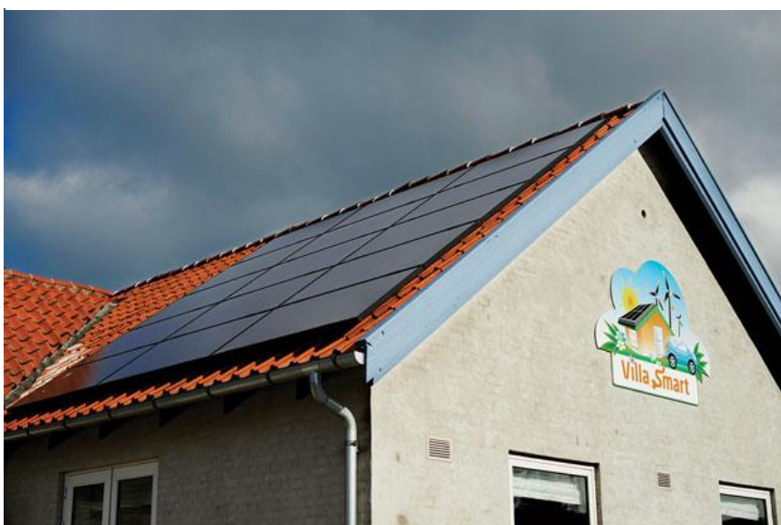
Impianti fv in edilizia pubblica
