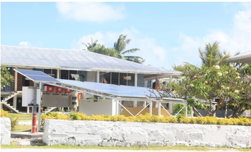
Impianti fv in edilizia privata
