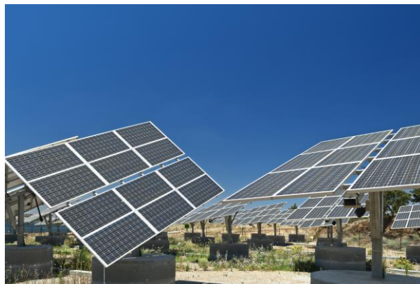
impianto ad inseguimento
