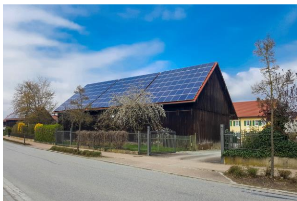
impianto su capannone
