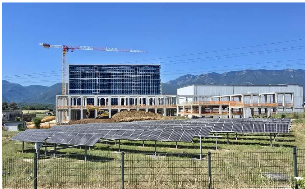
Figura 8. Cantiere per la realizzazione di un nuovo polo logistico per prodotti alimentari tra i comuni di Frosinone e Ferentino
